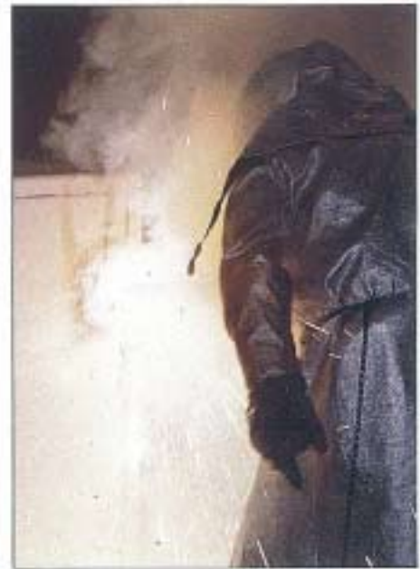
UL Torch/Tool Attack on Safe Door Jamb.
